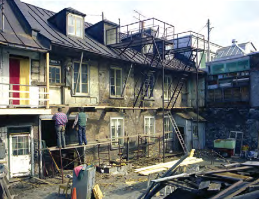
Travaux de rénovation dans une cour arrière de la rue D'Aiguillon, en 1982. AVQ; N020134.
